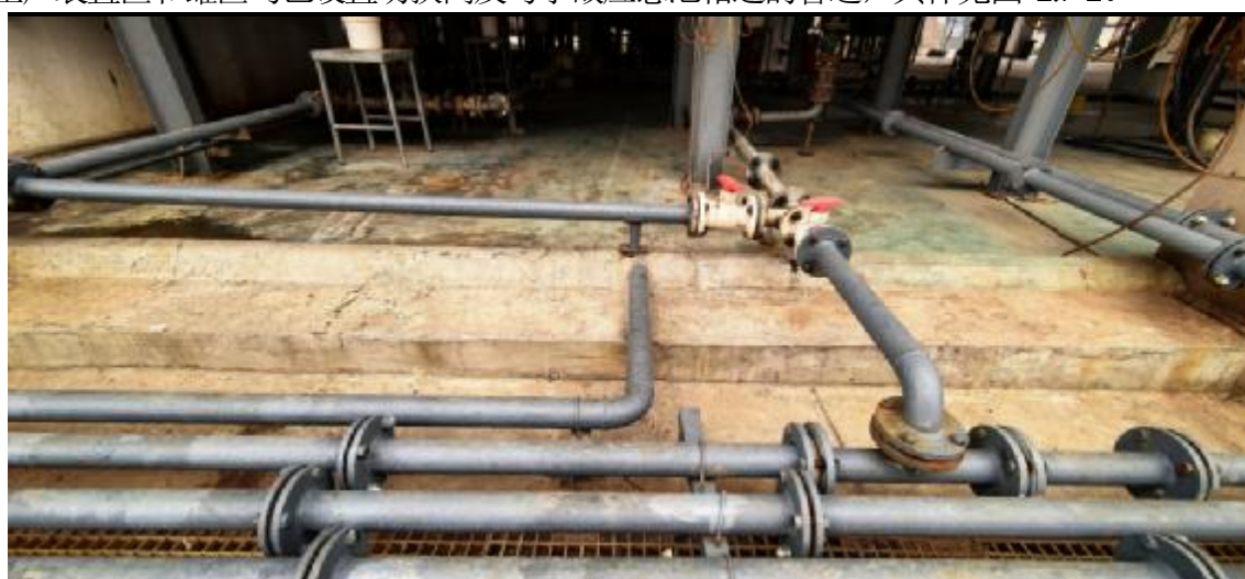
生产装置区切换阀及与事故应急池相连管道
