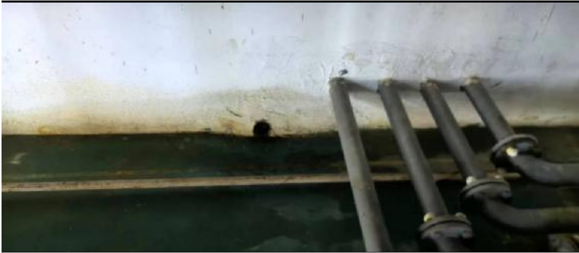
一车间反应釜围堰与事故应急池相连管道
