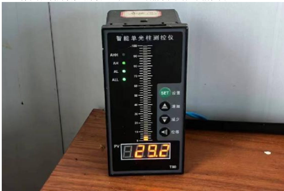
图 2.7-1 事故应急池液位计现状照片
