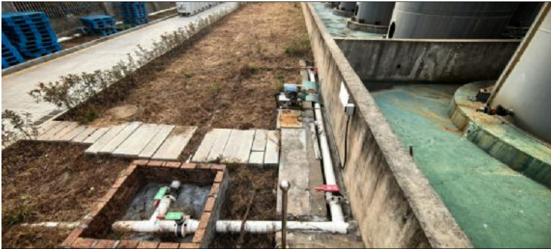
罐区切换阀及与事故应急池相连管道
