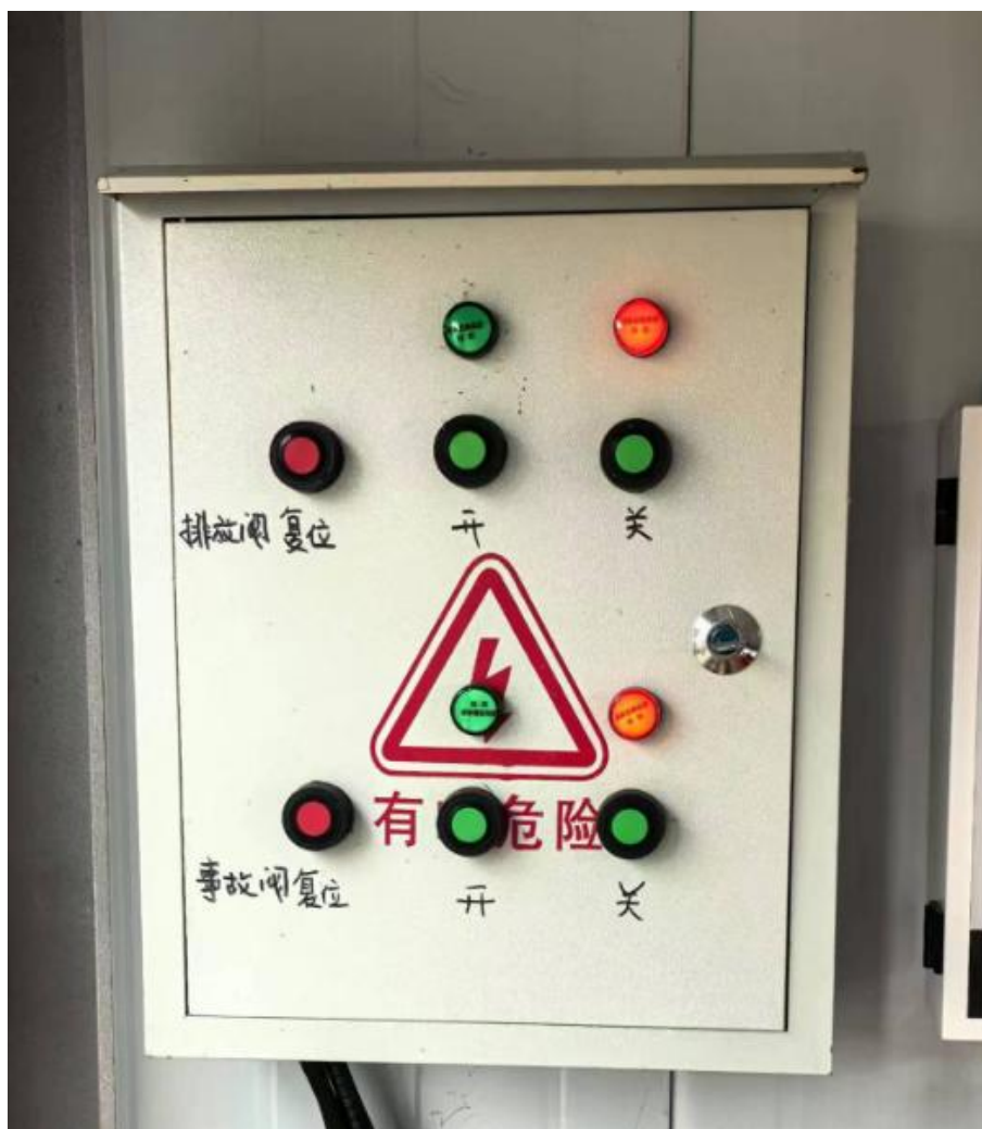
图 2.7-3 远程控制手自一体阀门现状照片
